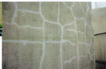
ひび割れにウレタン充填材を塗りこみ、割れを補修します。
